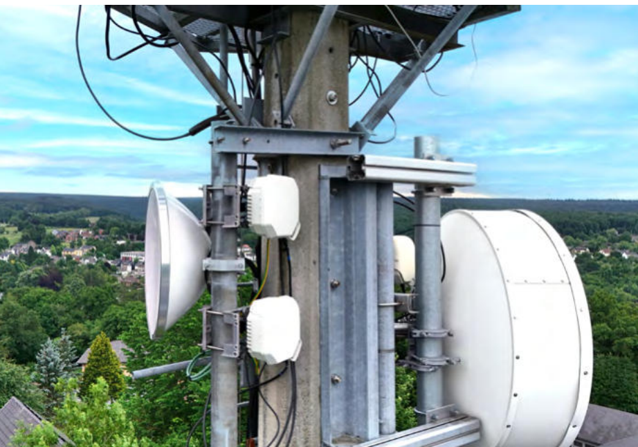
Eine neue, digitale Richtfunkstrecke zwischen dem Funkhaus in Eupen und dem Sendestandort Petergensfeld wurde eingerichtet.
