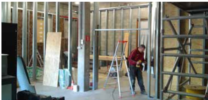
Das neue TV-Studio erlaubt eine weitaus flexiblere Nutzung. Im Bild der Bau der Zwischenwände.
